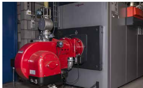
La nouvelle chaudière à condensation de dernière génération
