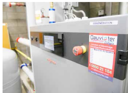
L'unité de cogénération installée à la maison Ternell.
