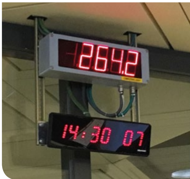
264 MW de puissance électrique produite à 14h30.
