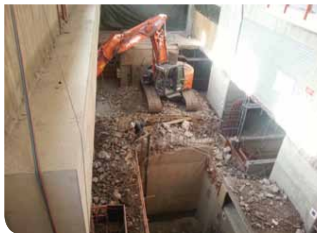
La démolition d'une partie de la centrale hydro-électrique de Lixhe (ici les cheminées et le niveau « salle des machines ») a généré une grande quantité de déchets de déconstruction, pour la plus grande part broyés et recyclés.
