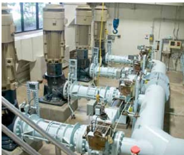
Les stations de pompage des eaux usées font partie des installations industrielles dont le fonctionnement peut être décalé pour optimiser l'équilibre production/consommation.
