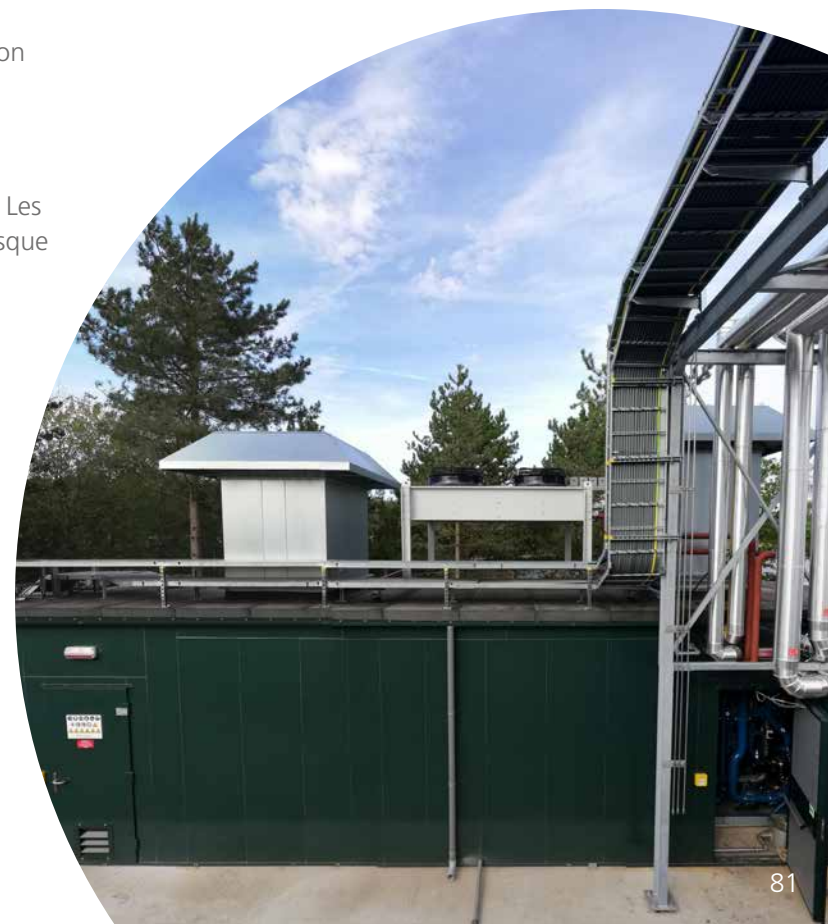
La nouvelle unité de cogénération.
