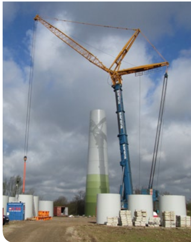
De windmolen van Puurs (2,3 MW) werd in dienst genomen in juli 2016. Hij bevindt zich in de buurt van de autosnelweg, in een industriezone dichtbij Antwerpen.
