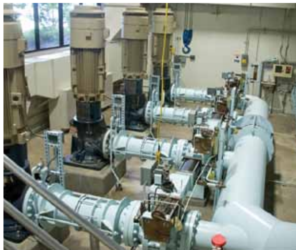
Het functioneren van de pompinstallaties van dit afvalwatersysteem kan in de tijd worden verschoven om het evenwicht tussen productie en consumptie van elektriciteit te optimaliseren.
